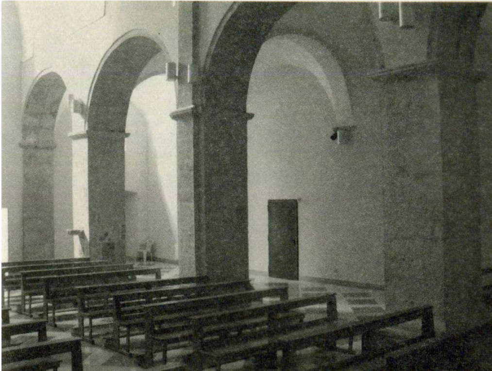
Interno della chiesa, lato SO. Grandi pilastri quadrati dividono la navata principale da quelle minori. La porta in fondo, riaperta di recente, dava adito alla prima sagrestia.
